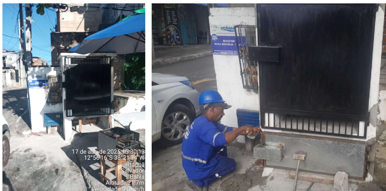
Figura 3 – Abrigo do booster no KM 17, em Itapuã
